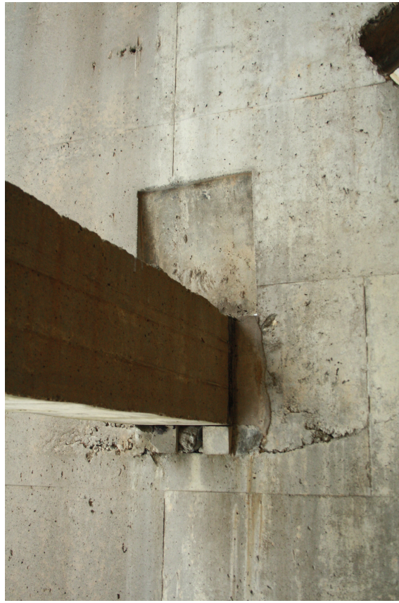
Figur C.18: Typisk utseende av kontakt mellom pilar og avstivningsbjelke i Storfossdammen.
