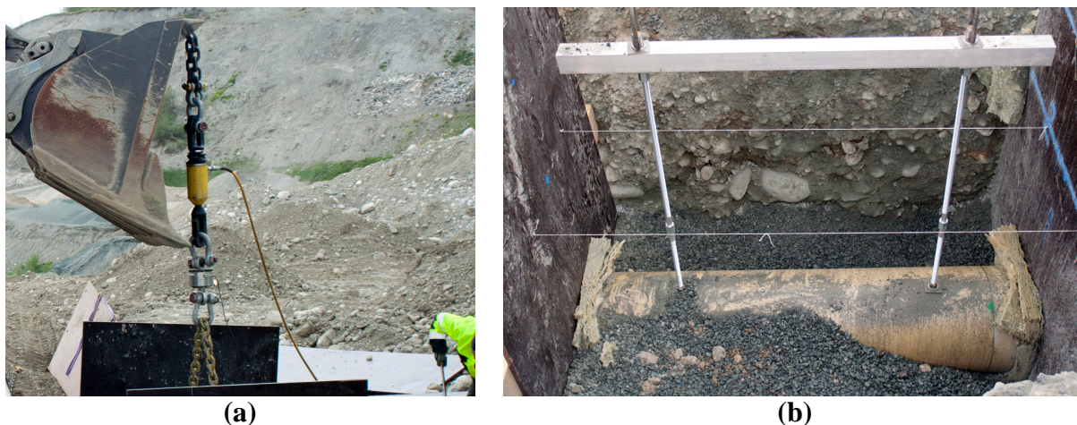
Figur 7.18: Oppløftsforsøk; (a) Jekk forankret i hjullaster (b) rør under påfylling av omfyllingsmasser
