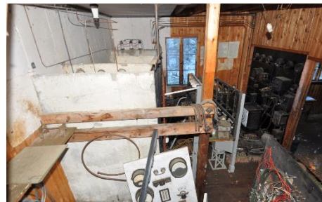
Figur 32. Apparatrom innvendig fra trapp. Foto: TGdP.
