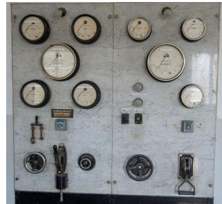
Figur 14. Instrumenttavle i Ytre Ålvik prov. Foto: NVIM
