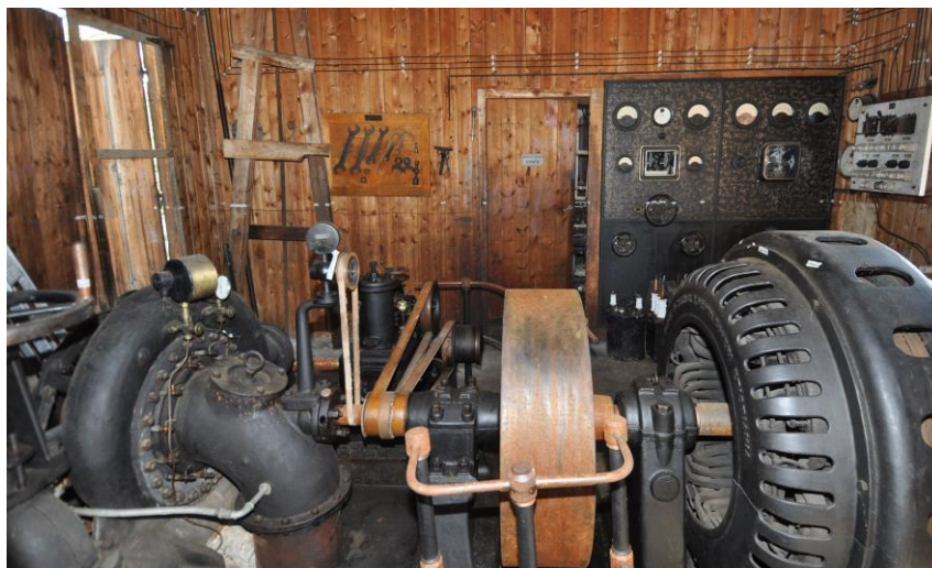
Figur 31. Maskinhallen (1) innvendig mot Apparatom. Foto: TGdP.
