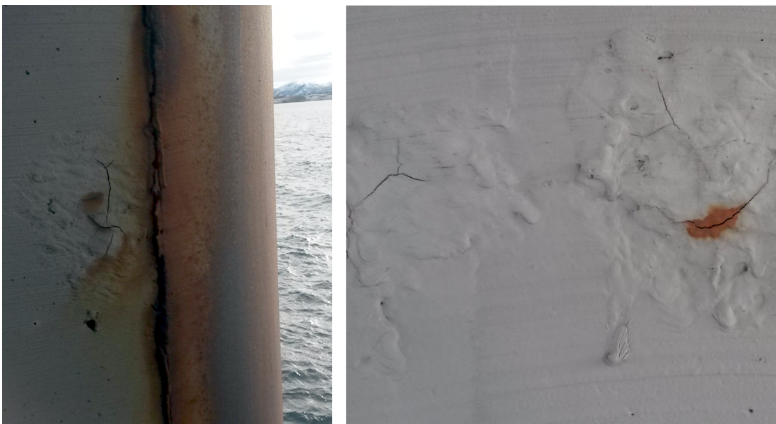
Figur 13.6: Riss og korrosjonsskader
