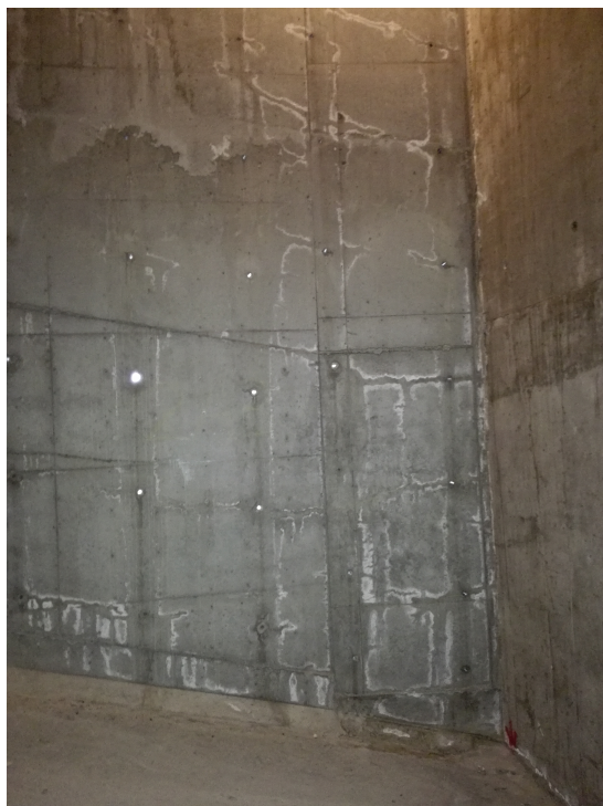
Figur 4.23: Saltutslag innside bru
