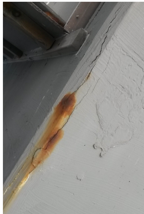
Figur 13.9: Riss og korrosjon søyle
