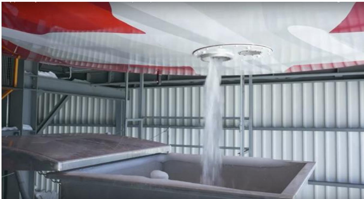
Figur 66 Tapping av vann ved toppstasjon (69)
