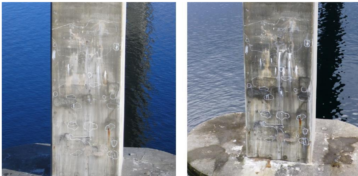
Figur 74 - Skadeutvikling i pilar i akse 5 nordside: t.v. 2006 og t.h. 2012 (Lund og Sten, 2013).
