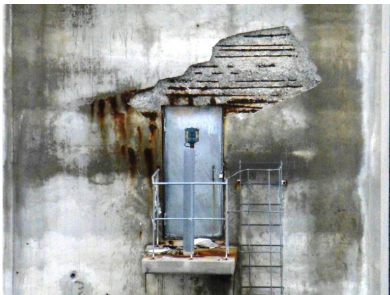
Figur 73 - Armeringskorrosjon og bom ved dør på pilar i akse 4, nordsiden i 2012 (Lund og Sten, 2013).
