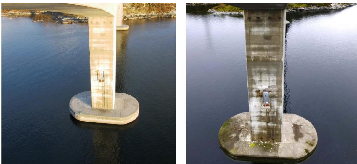
Figur 72 - Skadeutvikling i pilar i akse 4 nordside: t.v. 2006 og t.h. 2012 (Lund og Sten, 2013).
