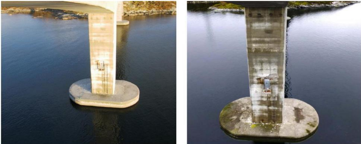
Figur 22: Forverring av søyleskadene, bildet til venstre er fra 2006 og bildet til høyre fra 2012. Merk at værforholdene var ulike på tidspunktet bildet ble tatt.
