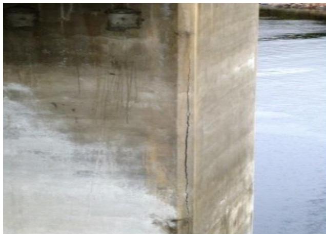
Figur 25: Vertikal sprekk på østre hjørne av søyle akse 4
