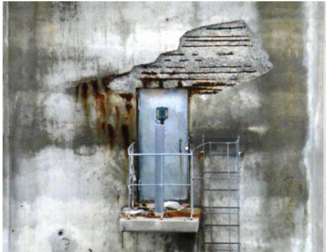
Figur 24: Viser bomskader på søyle akse 4
