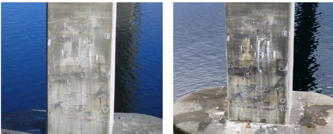
Figur 23: Skadeutviklingen i nedre del av hovedsøylene, bildet til venstre er fra 2006 og bildet til høyre er fra 2012
