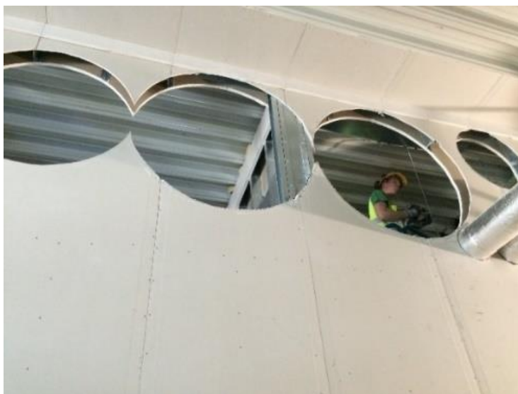
Bilde 1 Eksempel på manglende kollisjonskontroll
