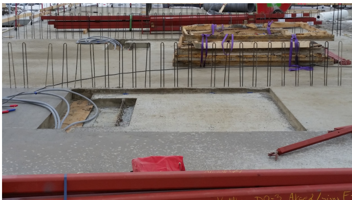
Figur 13: Nedsenket støp for våtromskabin (privat foto): Tekniske føringer som inntak for vann ligger i dekket. Stor utsparring for ventilasjon og avløpsrør. I bakgrunn kan man se forskalingen brukt under støpen
