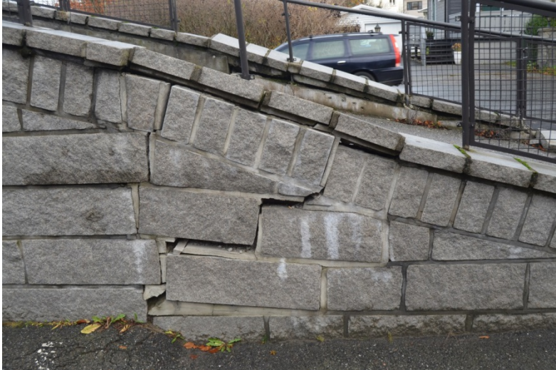
Figur 6.9: Bilde av østre landkar Hassingen Manuelt målte skader
