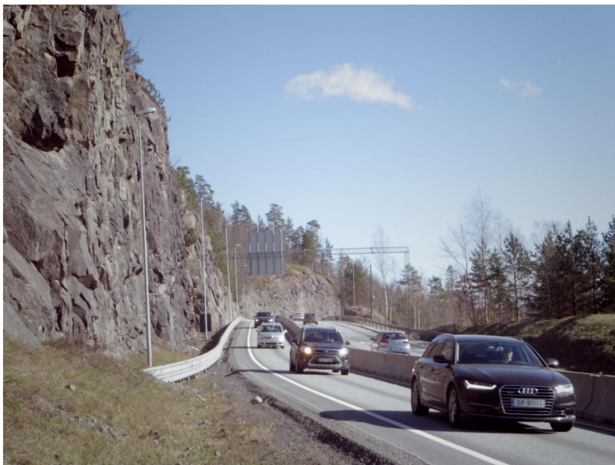
Figur 37 Bildet viser høye fjellskjæringer hvor det er fare for steinsprang og isnedfall vinterstid på strekningen i nærheten av Skaret (foto: forfatter).
