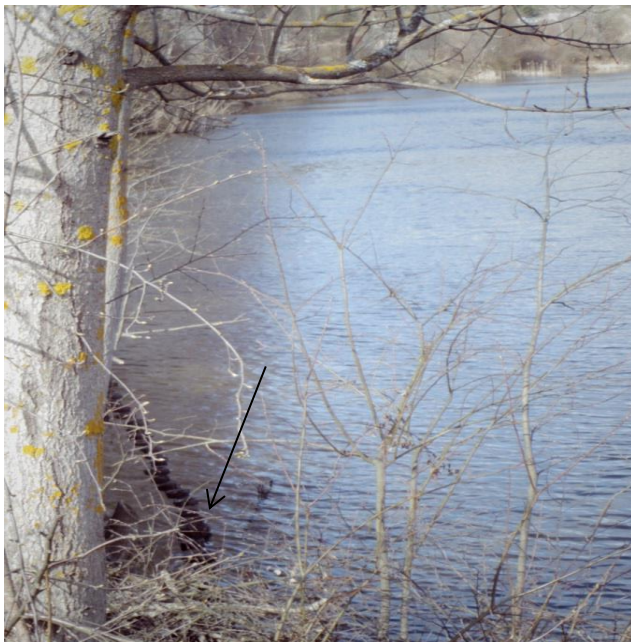
Figur 45 Bildet viser spor av breddeutvidelsen av Mælingen halvøya. En kan se hvordan påler (anvist med pil) har blitt slått ned i elva for å holde på plass fyllingen for utvidelse (foto: forfatter).
