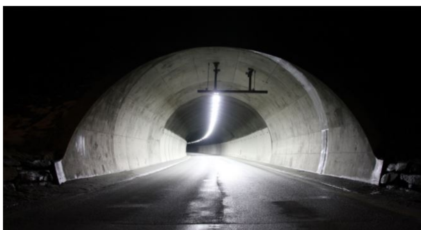
Figur 3.4: Innkjøringssone med LED-armaturer i Brekktunnelen [19]
