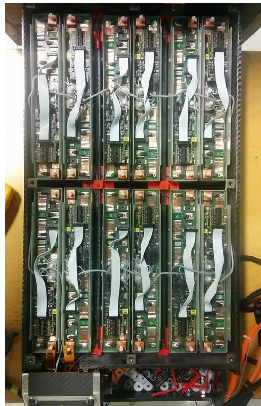
Figur 96 Batteripakken sett ovenfra uten lokk
