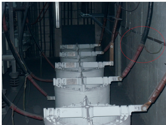
Figur 8.3: 240mm 2 -kabel med jordingsstropp - mellom kondensatorer i ovnsbygg
