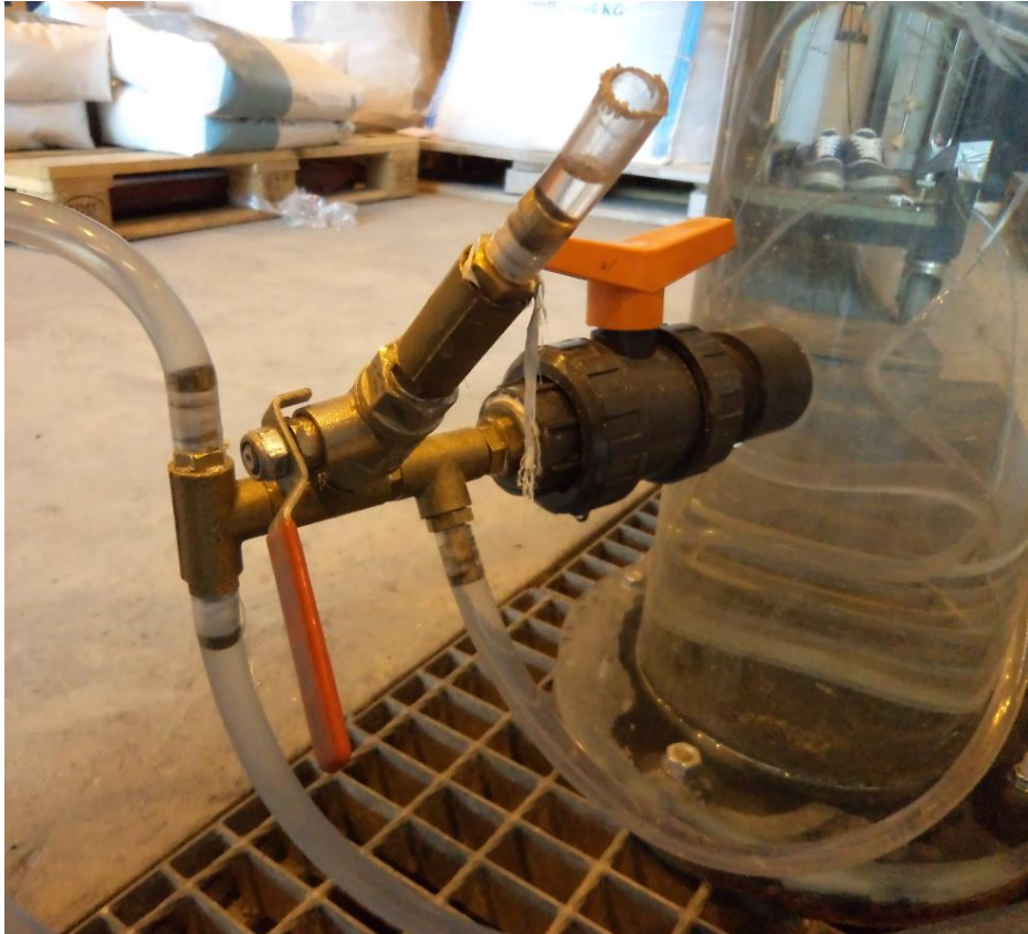
Figur 15: Reservoartankutløpet med reservoarventilen til høyre og utblødningsventilen til venstre. Helt til venstre sees T-koblingen med splittingen av væskestrømmen.
