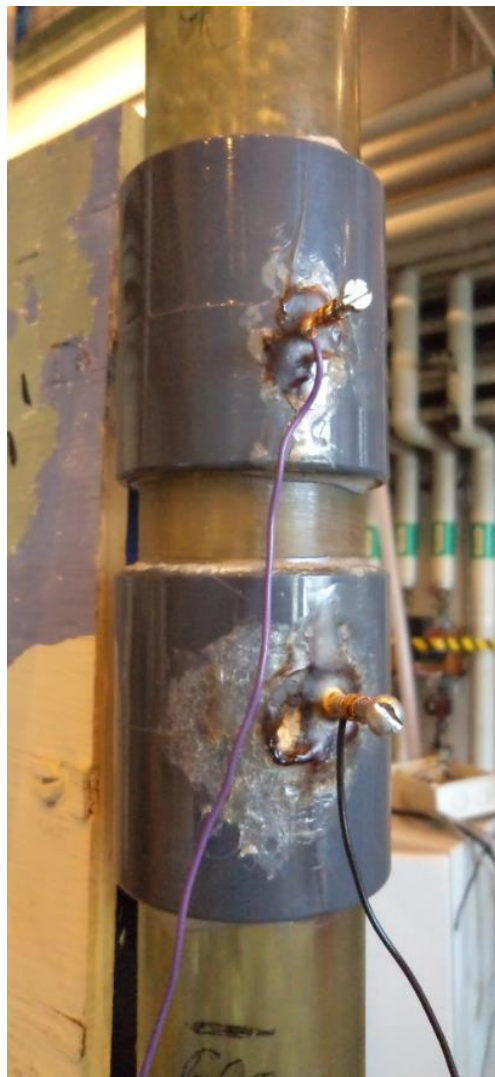
Figur 16: Ringlektroder i produksjonsrør med ledninger til transformator.
