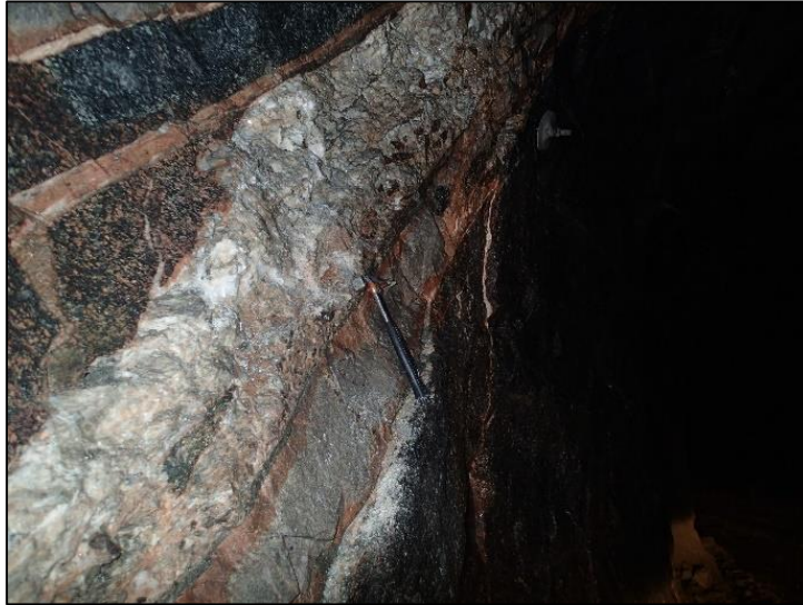
Figur 62. Bilde er tatt på høyre side av tunnelen, sett i retning med stigende pelnr. Bildet viser sleppen som krysset tunnelen. Hammer er lagt på som målestokk.
