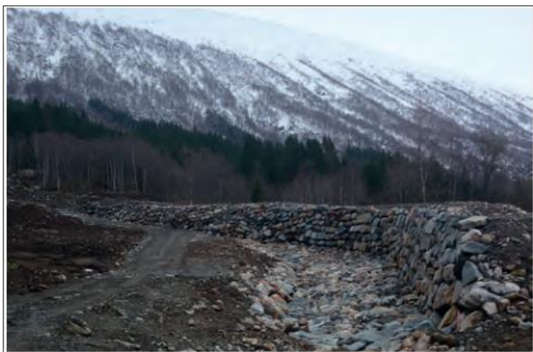
Figur 2.28 Ledevoll for å sikre bygninger mot flomskred. Ledevollen er 5 m høy og 100 m lang med plastring i bunnen for å hindre erosjon (Haugum et al., 2015).
