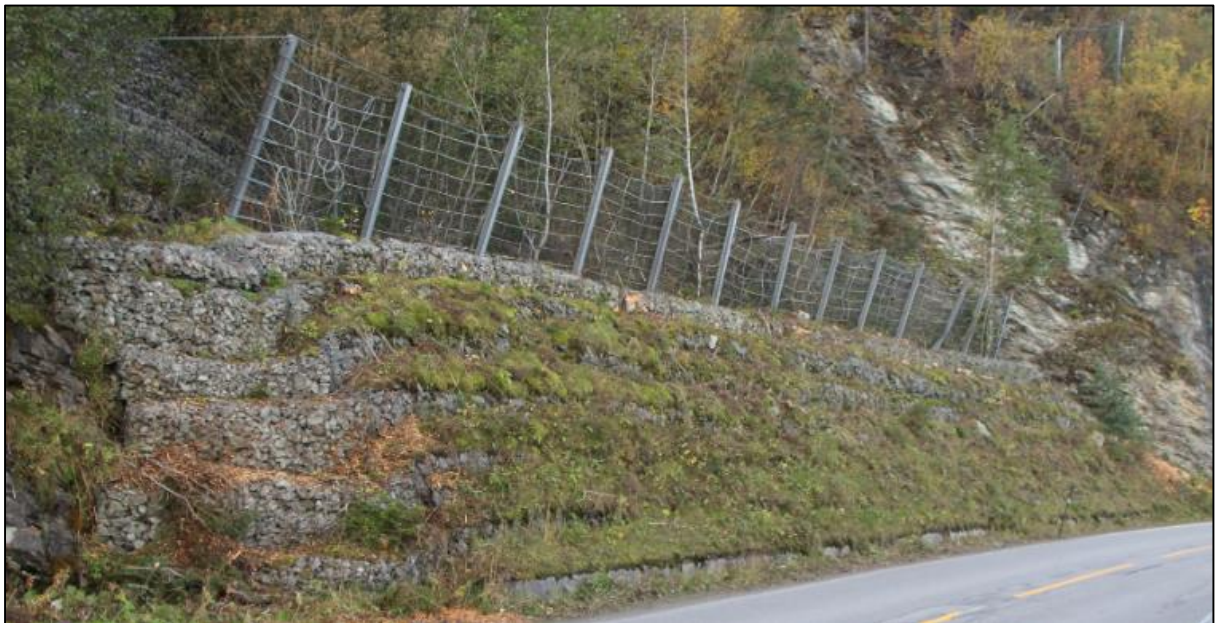
Figur 1.23 Kombinert fangvoll og gabionmur med fanggjerde på toppen langs Fylkesvei 715 (Foto: Erlend Alvestad).
