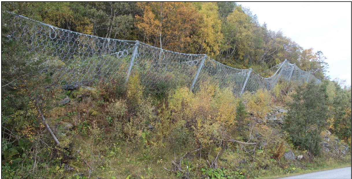
Figur 1.21 Steinsprangnett langs Fylkesvei 715 i foten av skråningen. Fanggjerdet er noe deformert fra tidligere steinspranghendelser (Foto: Erlend Alvestad).
