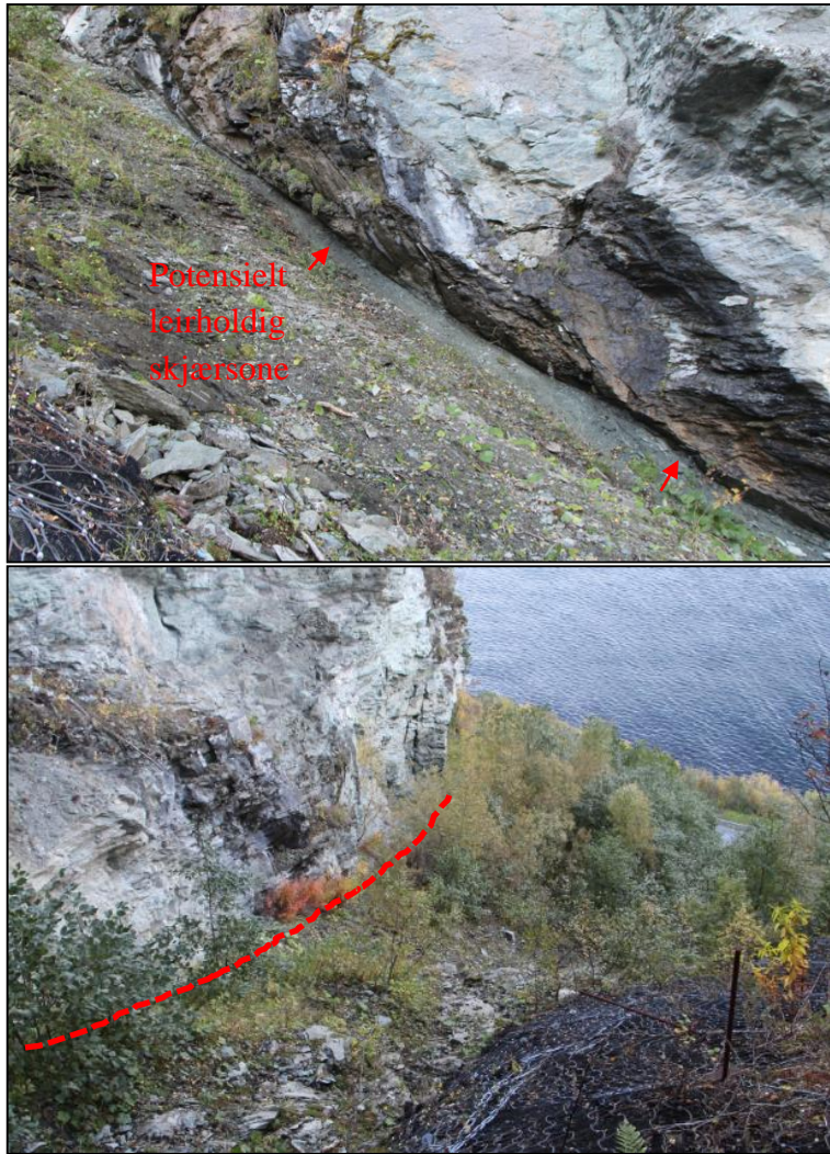
Figur 3.16 Den potensielle skjærsonen som underkutter fjellpartiet med fall ned mot veien (Foto: Erlend Alvestad).
