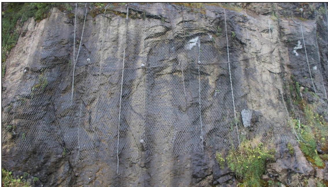
Figur 1.20 Kombinert steinsprang- og is-sikringsnett med vertikalhengende kjettinger som sikringstiltak mot nedfall av is langs Fylkesvei 715 (Foto: Erlend Alvestad).
