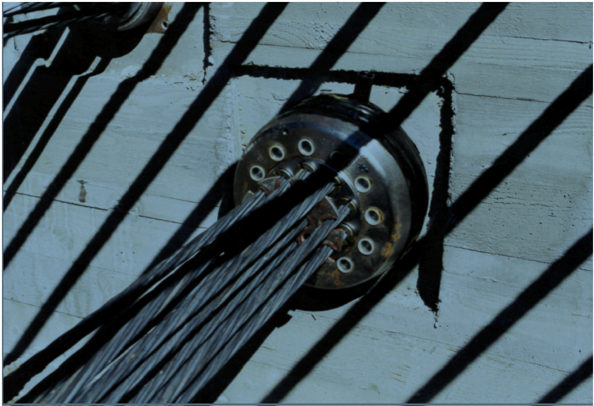
Figur 4: Spennkabler på Gulliksrud bru
