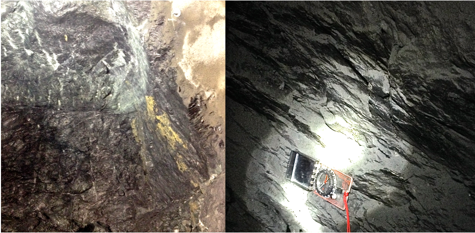
Figur 6.3: Bilde av fylltitten ved Hundvåg tunneltrasé. Bildet til venstre er fra stuff ved pel 8115 (bolt oppe til høyre for skalering). Bilde til høyre er fra porten mellom tunnellopene ved pel 7200
