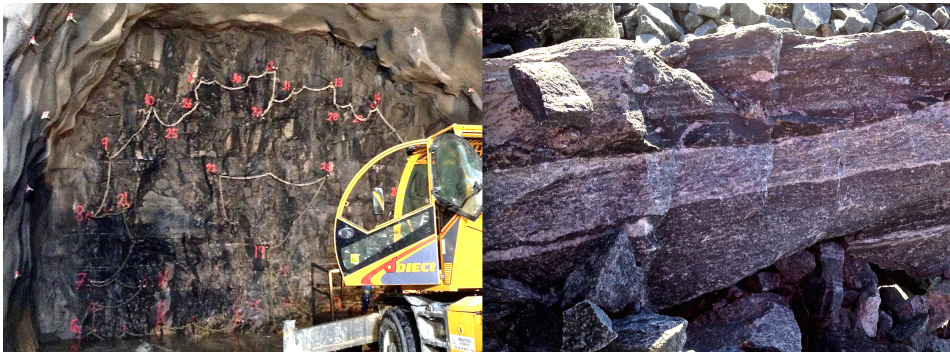
Figur 6.4: Bilde av gneisen ved Solbakk tunneltrasé. Bildet til venstre er fra stuff ved pel 17757. Bilde til høyre er fra en gneisblokk på ca 1 kubikk fra Solbakkstuffen.
