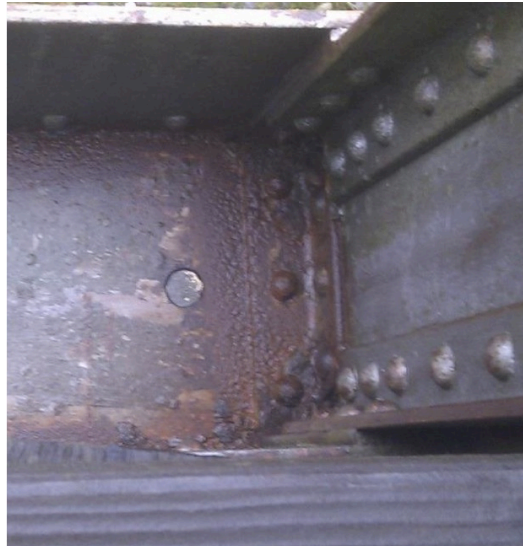
Figur 5-28: Korrosjon ved undergurten på Eidselva Bru. Foto: Jernbaneverket [24]
