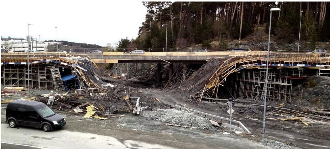
Figur 1.1: Rotvollhaugen bru etter kollaps av reis. Foto: NRK
