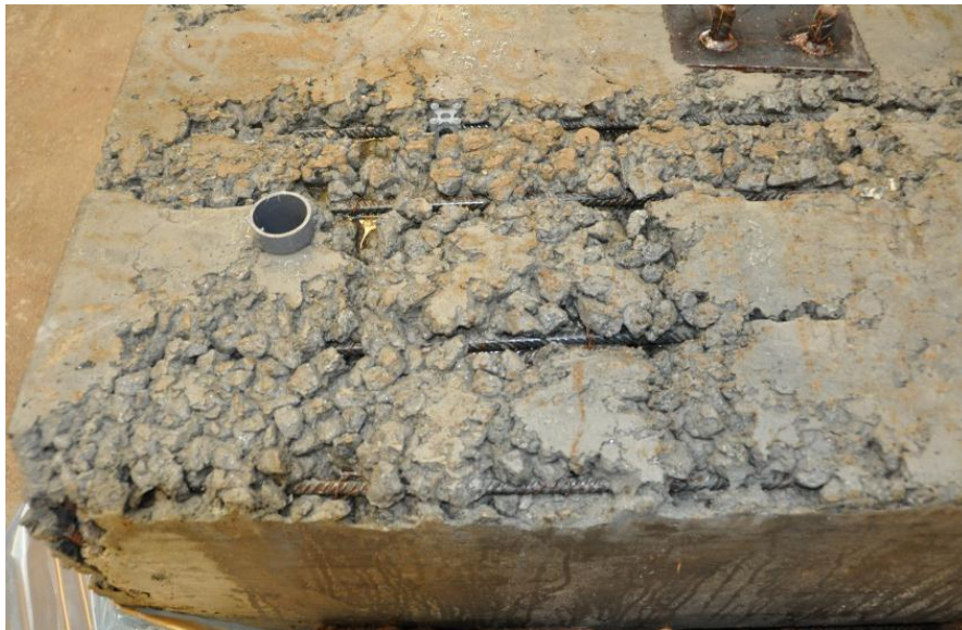
Figur 10.7: Uheldig overflate for betongvegg
