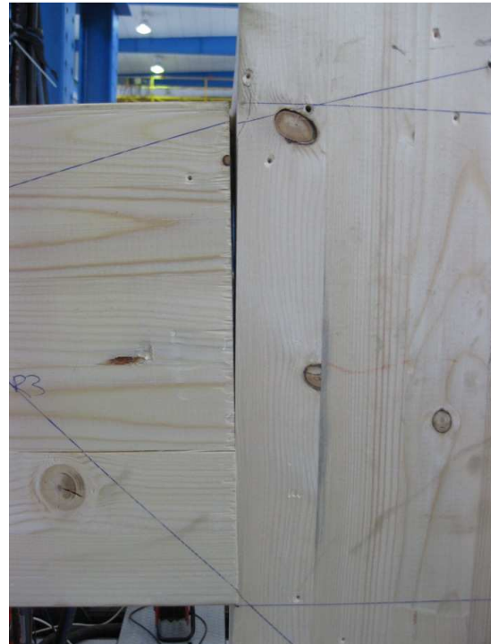
Figur 15: Synlig åpning mellom bjelke og søyle ved brudd.
