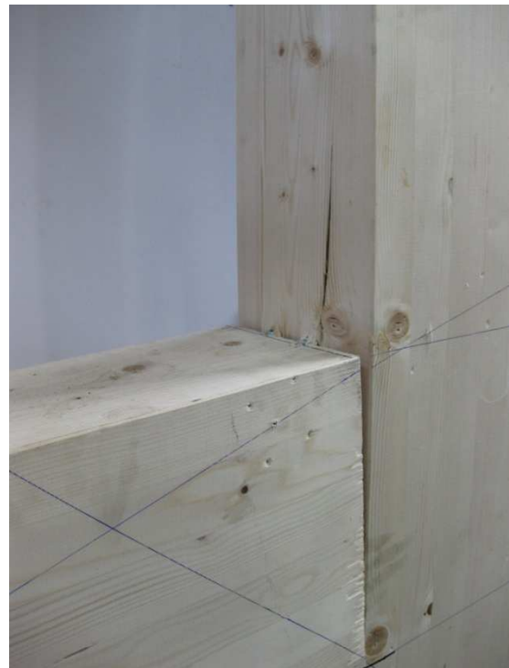
Figur 13: Oppsprekking langs søylens fiberretning.
