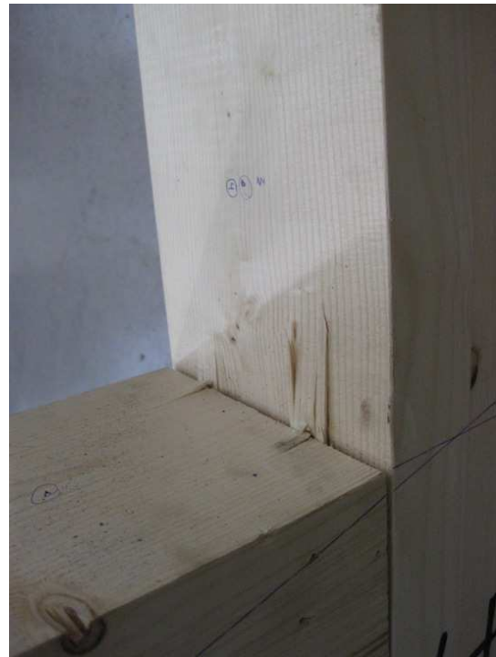
Figur 17: Oppsprekking langs søylens fiberretning.
