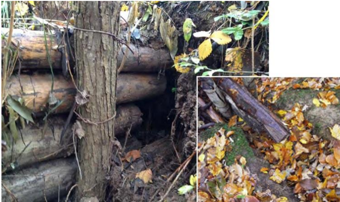
Figur 5: Erosjon på den laterale delen av en stokkdam i Slovakia(foto Braskerud et al. (2014)).
