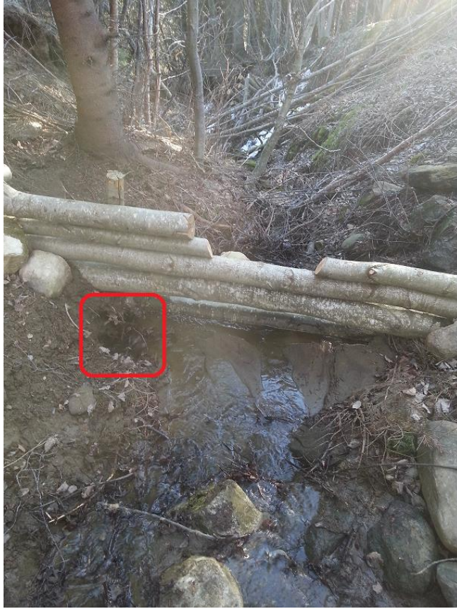
Figur 33: Bilde av øvre stokkdam Engan. Rødt markerer hvor vannet har erodert seg i det oppbygde materiale. Bildet er tatt 13.03.2015.
