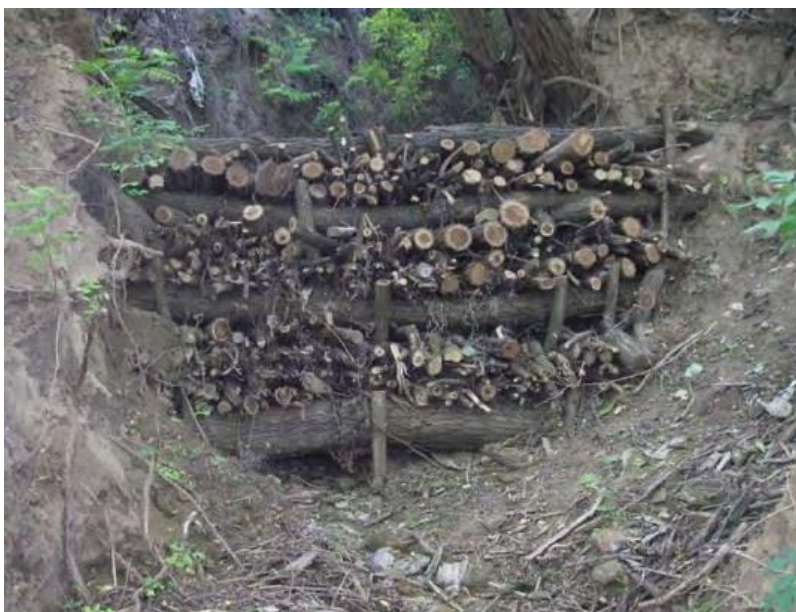
Figur 3: Erosjon under den nederste stokken på en kvistdam i Slovakia(foto Braskerud et al. (2014))
