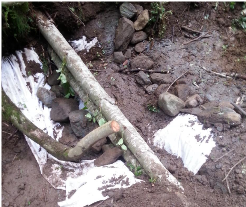
Figur 15: Stokkdam Engan er her halvferdig. Fiberduken ligger begravd oppstrøms og forankringen er ferdig lagt. I tillegg ser man steinene som sikrer erosjon nedstrøms ligger oppå fiberduken. Bildet er tatt 17.08.2014.
