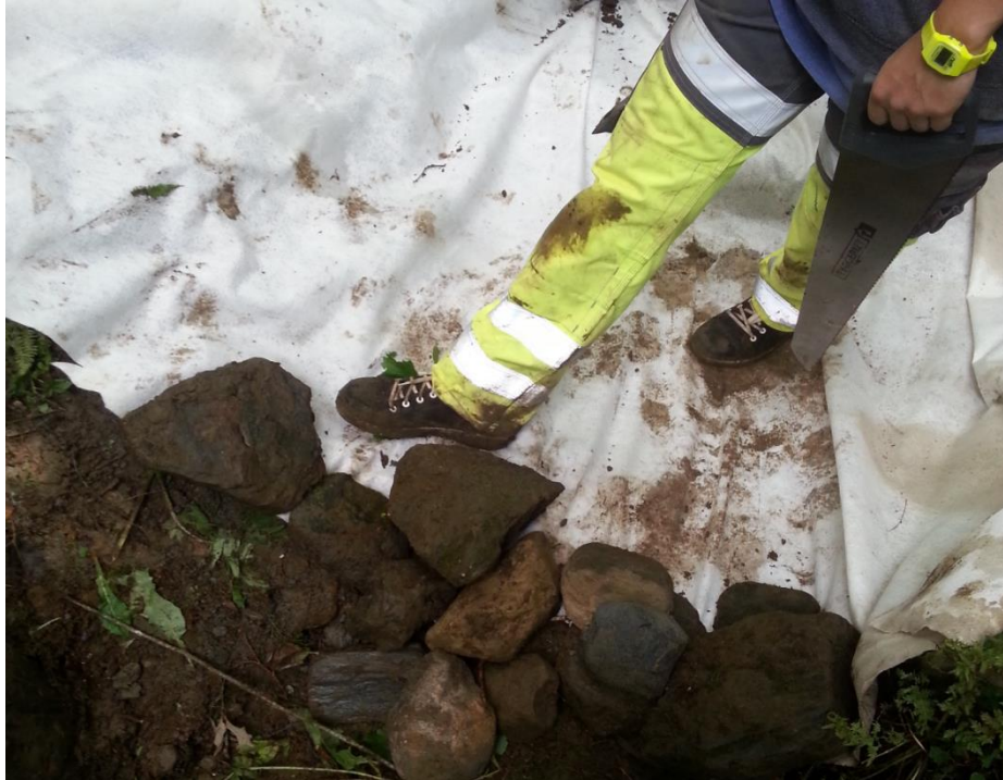
Figur 14: Legging av stein for forankring av fiberduk. Fiberduken er lagt i en slisse under steinene. Bildet er tatt 17.08.2014.
