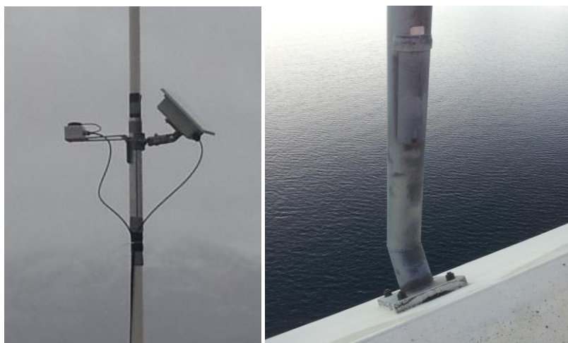
Figur 3.20: WiFi antenne og GPS mottaker montert på hengestang (t.v.), og luken til en av lysmastene (t.h.)
