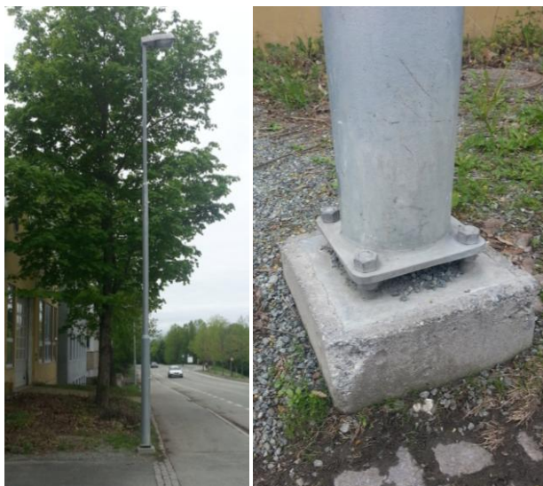
Figur C.7: Testing av dynamiske egenskaper til referanselysmast på NTNU, som sammenligningsgrunnlag for lysmasten anemometerkonstruksjonen monteres i på Bergsøysundbrua
