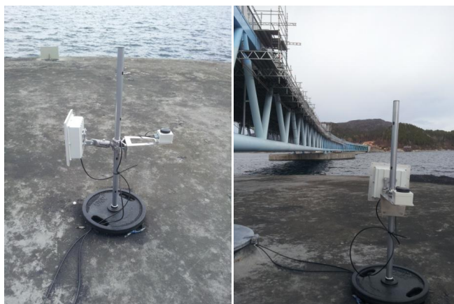
Figur 3.31: Stativ for montering av WiFi og GPS mottakere
