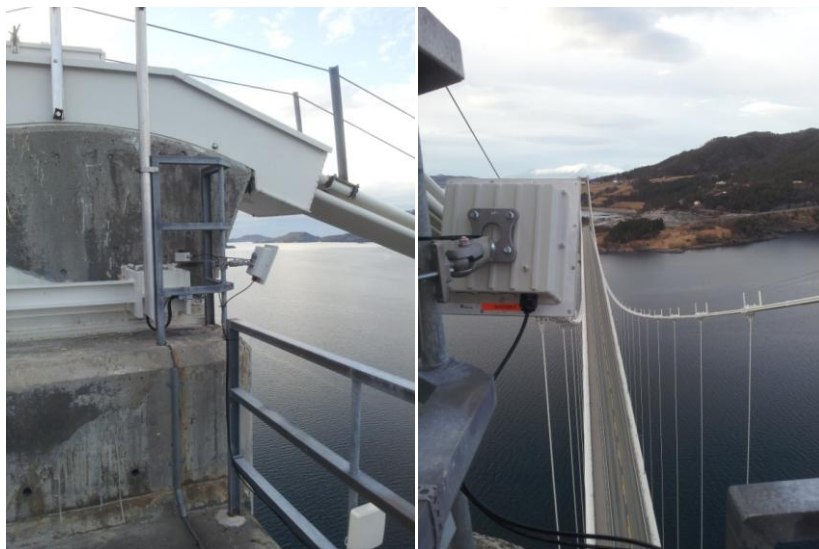
Figur 3.22: Montering av WiFi antenne og GPS mottaker til hovedlogggestasjonen i toppen av søndre tårn
