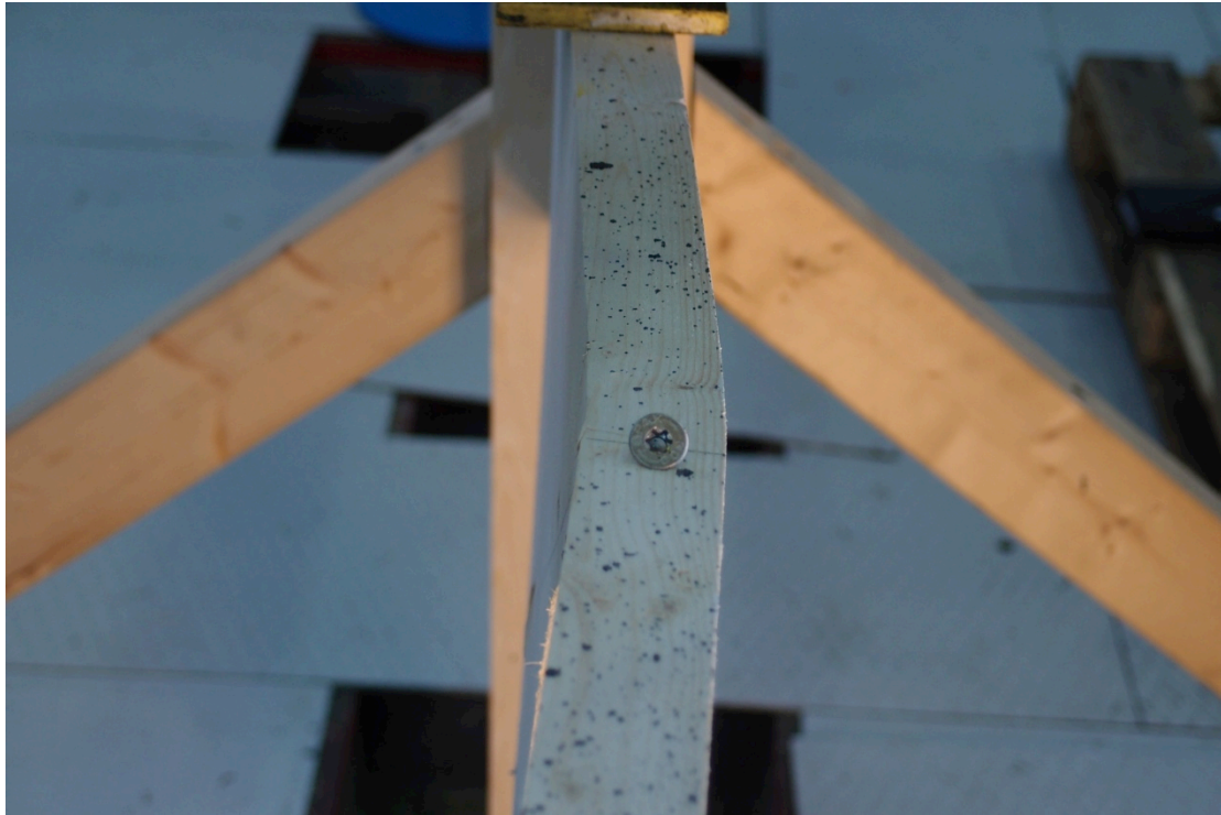
Figur 117: Lokal utbøyning av bjelke
