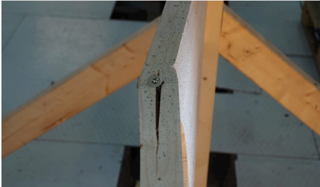
Figur 124: Lokal utbøyning av bjelke
