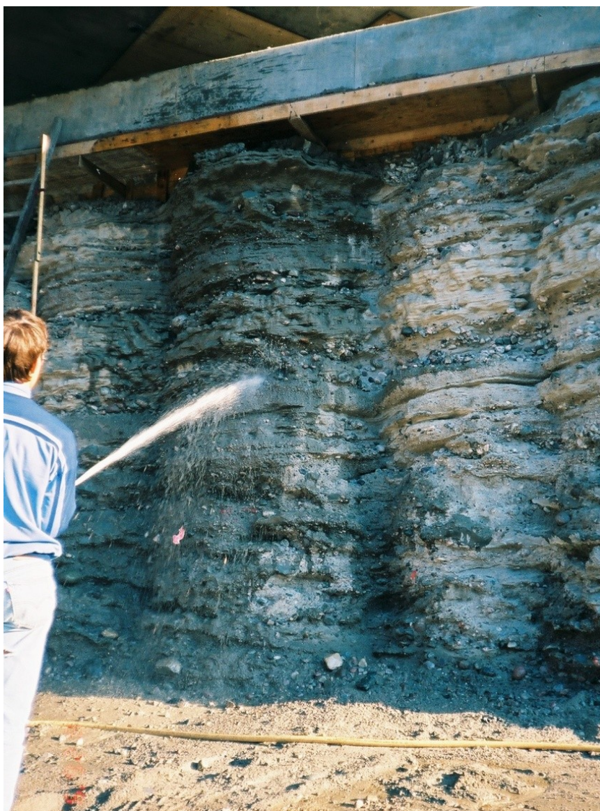
Figur 2.3: Kontinuerlig vegg av jetpeler ved Porsgrunn, Telemark. Pelene er laget med geobetongmetoden hvor jordmassene fungerer som tilslag.
