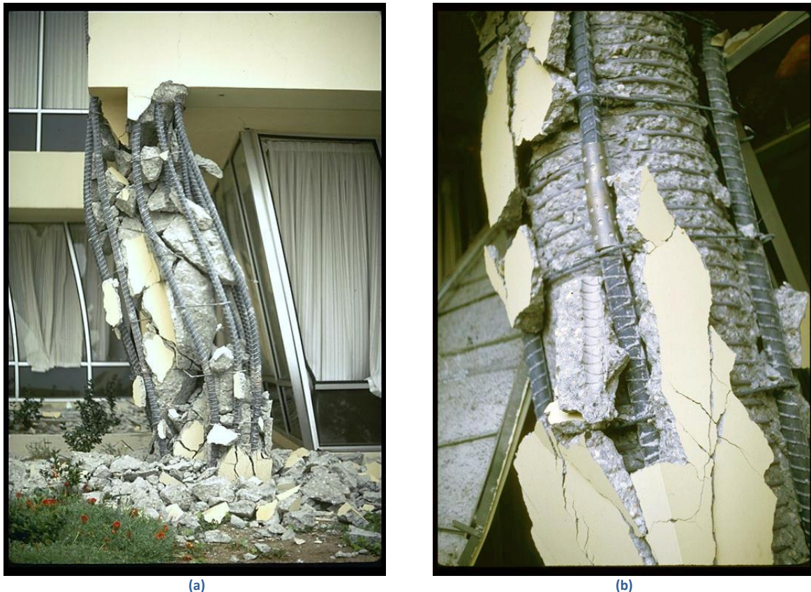
Figur 2.10: Bilde (a) viser en betongsøyle som ikke har tilstrekkelig bøylearming. Betongkjernen er fullstendig knust og søylen har nesten mistet all sin styrke. Bilde (b) viser en søyle som er tilstrekkelig omsluttet av bøylearming. Her hindrer bøyene betongen i å utvide seg. Dette gjør betongen sterkere og kjernen er fortsatt intakt etter skjelvet. Begge søylene er fra Olive View Hospital og bildene er tatt etter San Fernando jordskjelvet i 1971 (Faison, et al., 2004).
