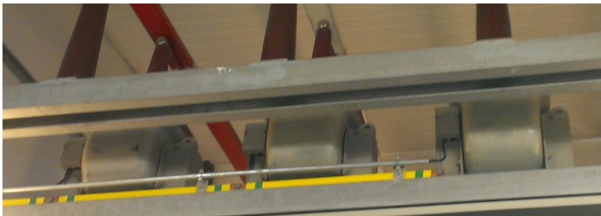
Figur 2-15: VT på 66kV siden ved Sildrebekken kraftverk
