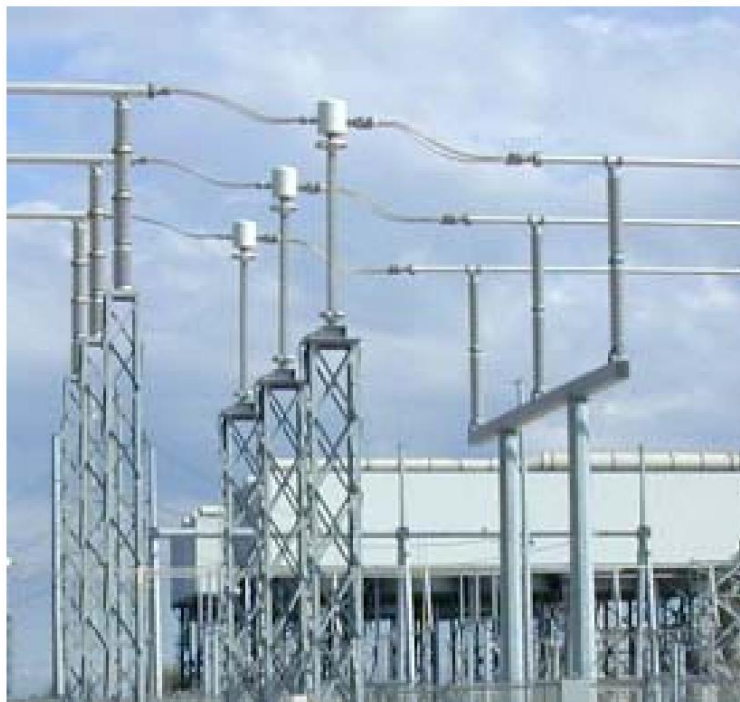
Figur 4-10: OCT montert ved Hays nettstasjon i USA [21]
