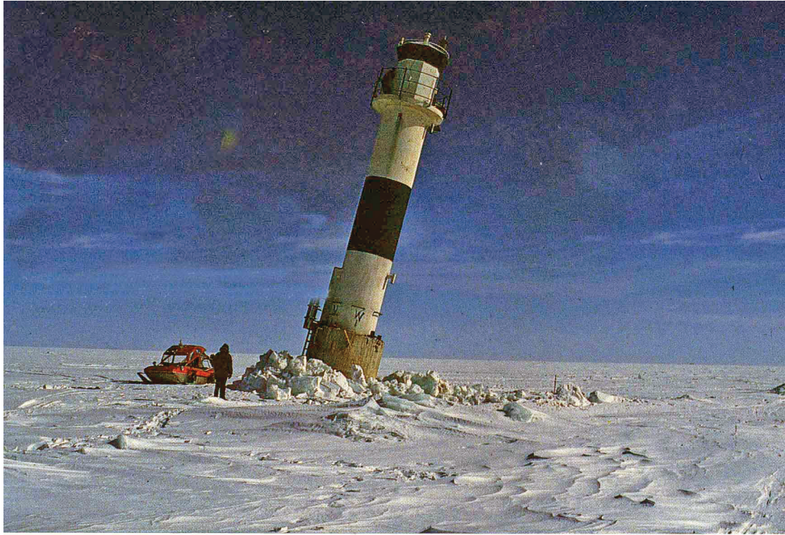
Figure 2.4: Björnklacken, after failure in 1985 (Engelbrektson 1987)
