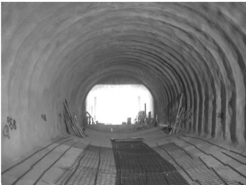
Figur 3-2 Tunnel de Viret tildekket av vanntett membran i konstruksjonsfasen (Holter, et al., 2010)
