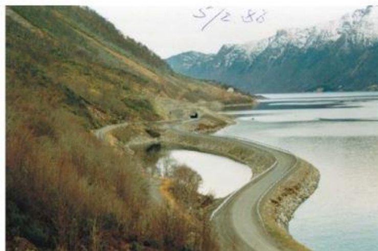
Figur 4-18 Utflytting av veg på sjøfylling. Fv 70 langs Hjørundfjorden, 1988 (Foto: Arnold Hustad, i Håland, 2012).
