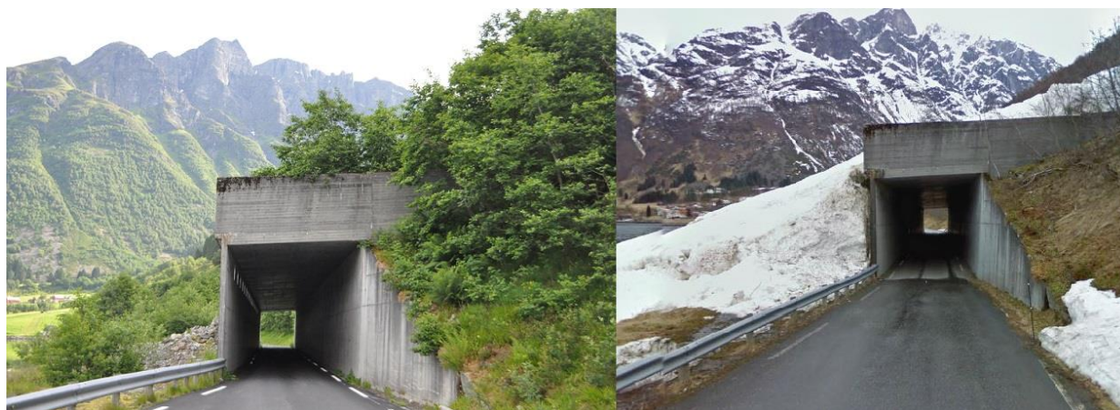
Figur 4-13 Rasoverbygg ved Løggjølet på fv41, juni 2013 (Foto: venstre: Marie Drågen Belland. Høyre: Skjermdump Google Maps).
