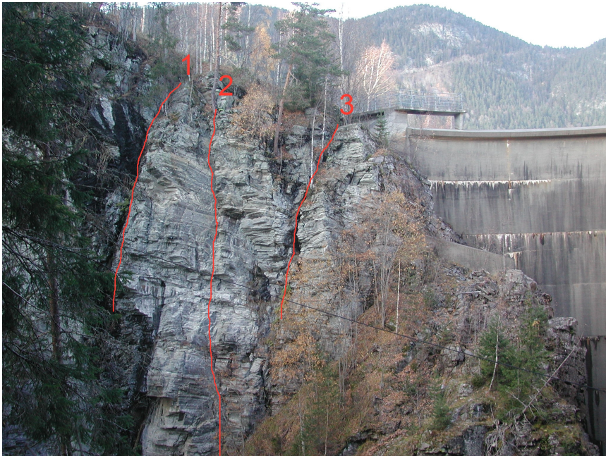
Figur 7.3: Slepper/sprekker i høyre vederlag. (Bilde fra Halvorsen, Multiconsult, 2012)
