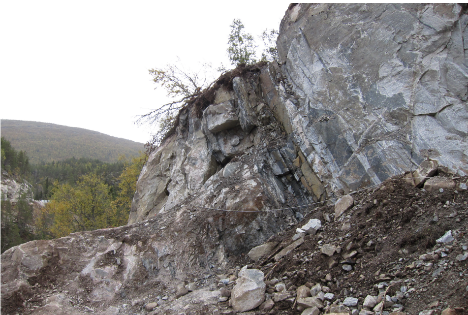
Figur 5.9: Svakhetszone i toppen av høyre vederlag.
