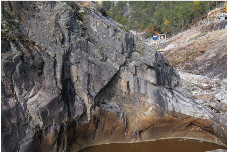
Figur 5.5: Eksempel på eksfoliasjonsoppsprekning like nedstrøms dammen.
