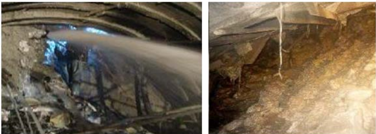
Figur 6-2 Bilde til venstre viser vanninnlekkasje med høyt trykk. Bilde til høyre viser materialet fra en svakhetsone mot TBM maskinen (Carter, 2011).
