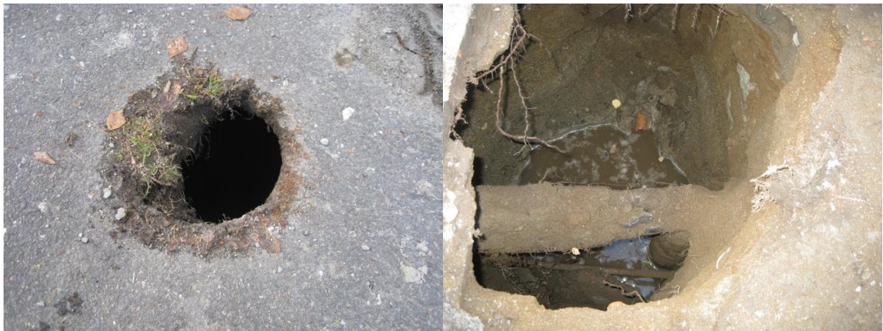
Figur 5. Disse to bildene illustrerer setningsskader rundt en underdimensjonert brønn i leire. I fotoet til venstre kan man se et hull i asfalten som har oppstått på grunn av setningsskader. I bildet til høyre er det samme hullet zoomet inn og her kan man se at leirmassene har sunket sammen nedi hullet (Foto: Ramstad 2012).
