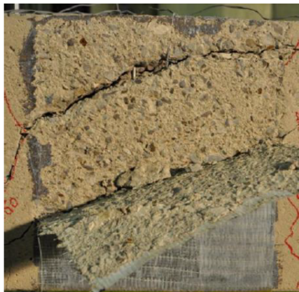
Figur 3.9 Avskalling av betong (Baggio, 2003).
