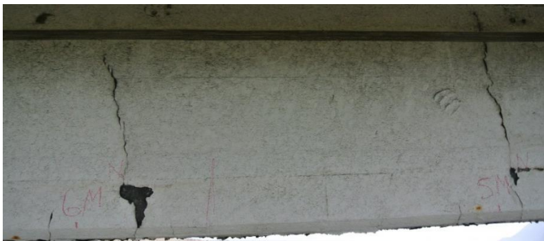
Figur 10.7 Riss som går opp langs siden, ca. 1 meter mellom
