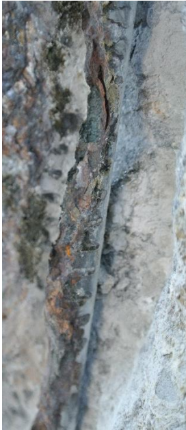
Figur 10.24 Armeringskorrosjon på bøyle i fundament
