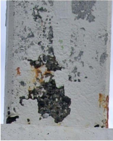
Figur 10.2 steinreir i overgang søyle - fundament, akse 5
