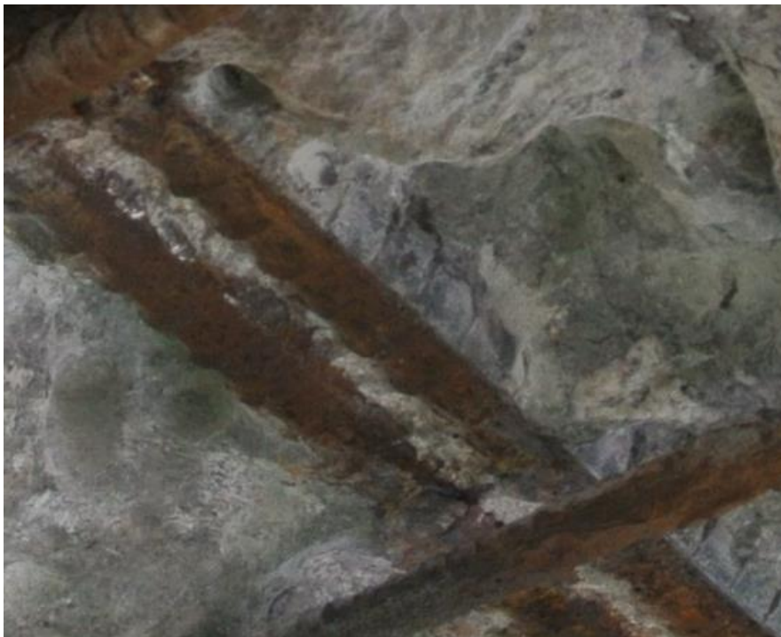
Figur 10.32 Korrosjonsprodukt på underside av lengdearmringing
