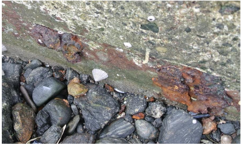
Figur 10.3 Rustutslag på fundamenter ved bakkenivå
