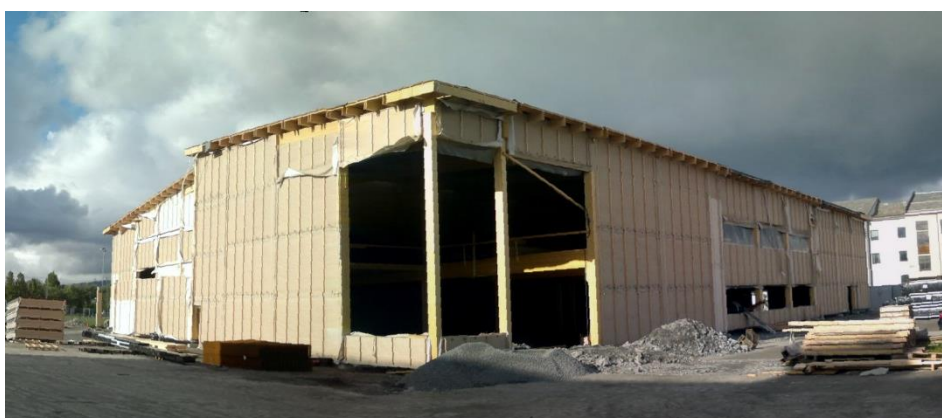
Figur 4.21 - Råbygget til Bankgata flerbrukshall, ferdig montert etter seks uker. Foto: Joakim Dørum.
