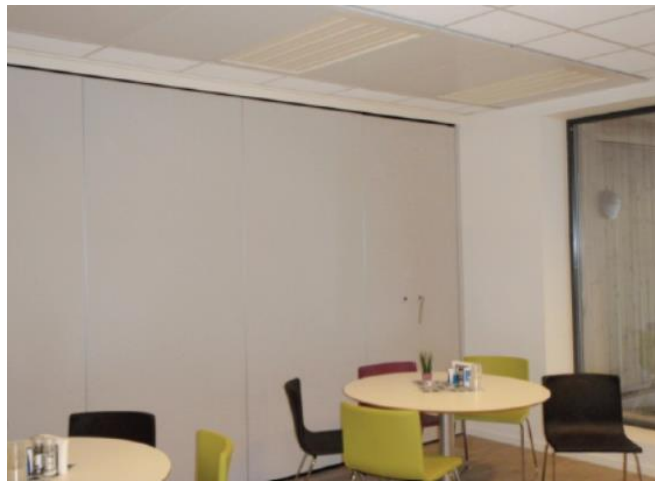
Figur 17: Varmepaneler integrert i himlingen i kontorbygget [46]
