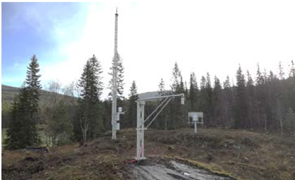
FIGUR 1-2 MÅLESTASJON ETABLERT I REGI AV JERNBANEVERKET. TIL VENSTRE VINDMAST MED VINDMÅLER, TEMPERATUR- OG FUKTMÅLER OG EL-SKAP. I MIDTEN SNØDYBDEMÅLER. TIL HØYRE NEDBØRMÅLER.
