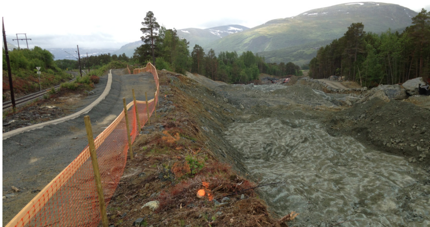
Figur 27: Bilde fra byggeperioden som viser samme område som på Figur 18. Entreprenør har avdekket fjellet
