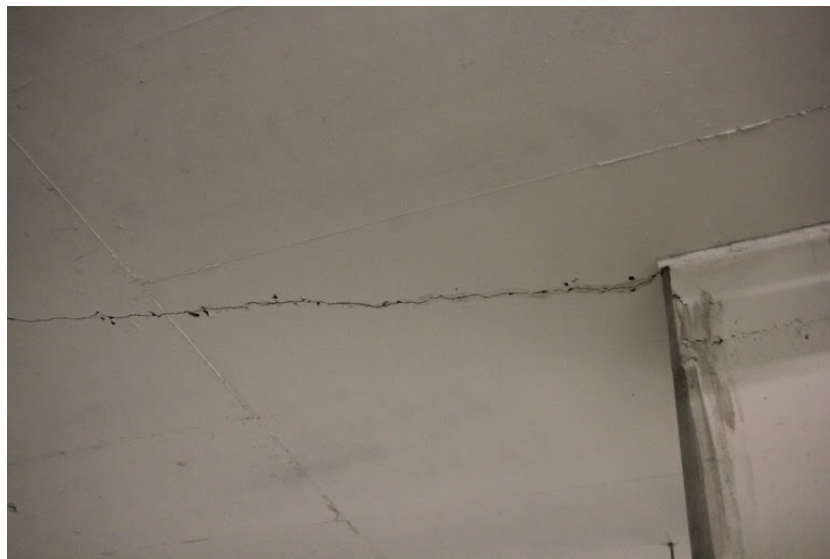
Figur 6.4: Observert riss under befarings på Munkvoll Gård. Risset kommer sannsynlig av svinn, temperatur eller fastholdning av hjørnet. Foto: M. Sivertsen.
