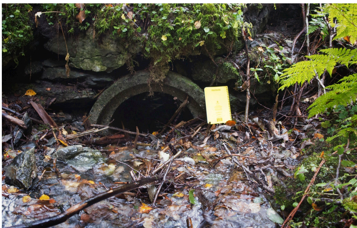
Figur 5.5: Stikkrenner. Øverst: knekt stikkrenne fylt med sedimenter, bilde tatt 22.07.2014. Nederst: stikkrenne med diameter 30 cm, der halve inntaket er fylt med kvister, løv og sedimenter, bilde tatt 24.09.2014. Lengde av gul bok er 17 cm. Boken er brukt som målestokk videre i oppgaven (Foto: Synne Tveiten).
