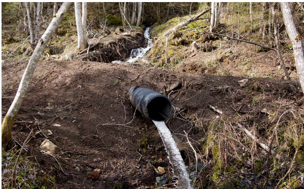
Figur 8.2: Ny stikkrenne som håndterer avrenningen fra den skrånende bekken. (Foto: Synne Tveiten, 26.04.2015).
