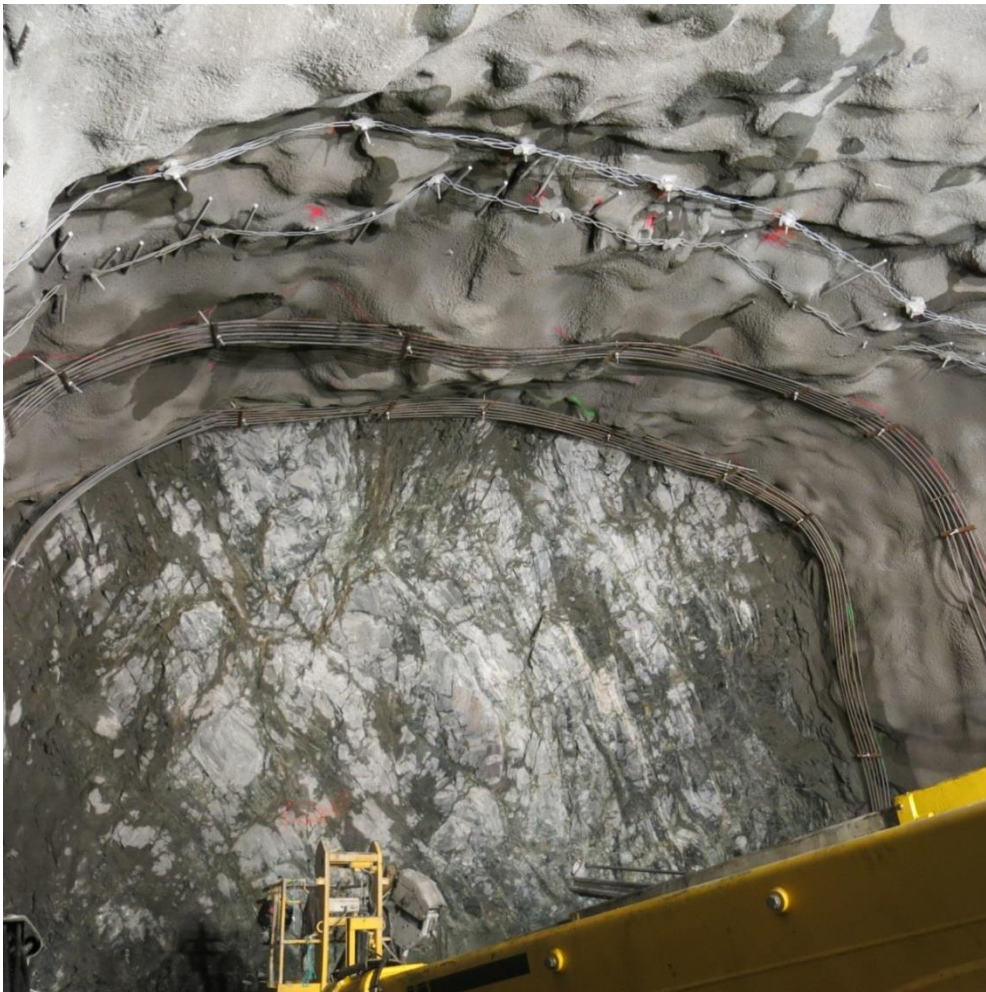
Figur 4.5. Oppsetting av to sprøytebetongbuer i Solheitunnelen før påføring av sprøytebetong. Forbolter med bånd er også satt inn i bakkant.
