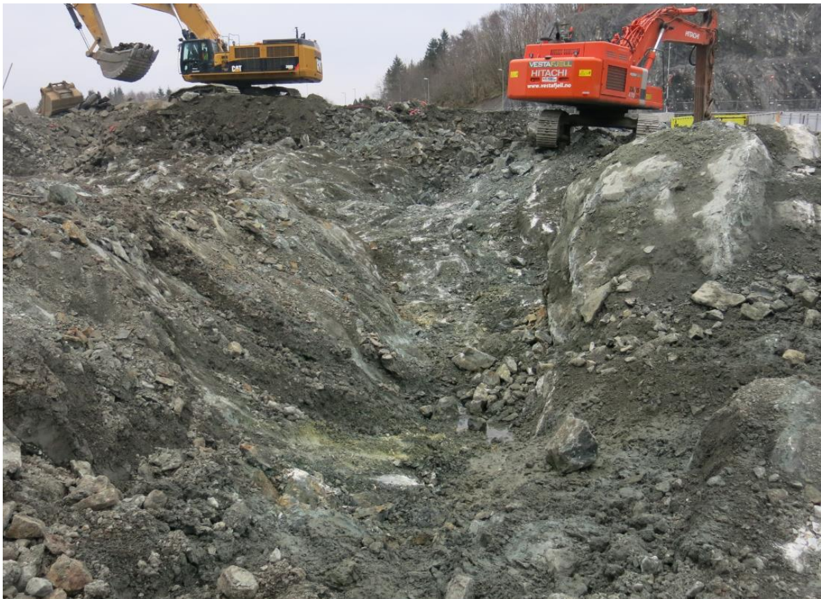
Figur 6.25. Søkk i overkant av Fleslandstunnelen mellom pelnummer 19666 og 19672, februar 2014.
