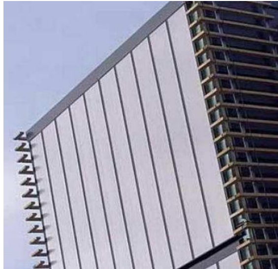
Figur 11 - Solfangere på Bravidabygget er montert på sørsiden av veggen
