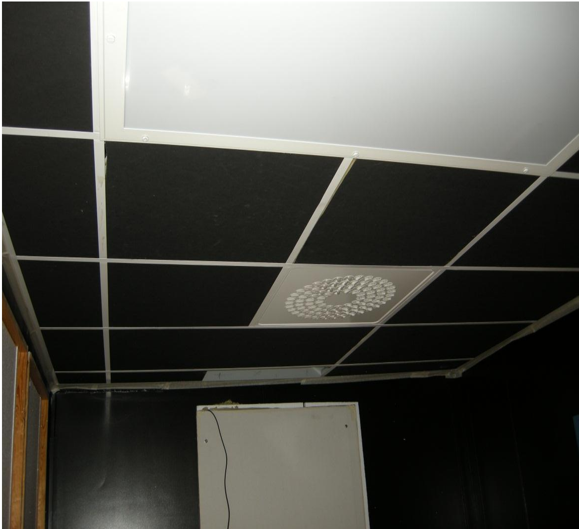
Figur 28: Colibri CR 200-600 med ALSd 125-200 plassert i himling i forsøksrommet.
