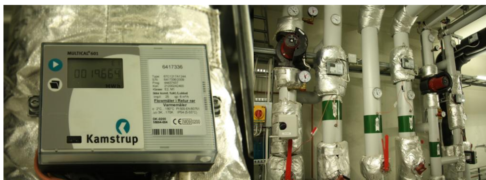
Figur 19, Eksempel på fjernvarmemåler (t.v.) og varmesentral med målere på henholdsvis radiatorkrets, ventilasjonsaggregater og tappevann (t.h.)
