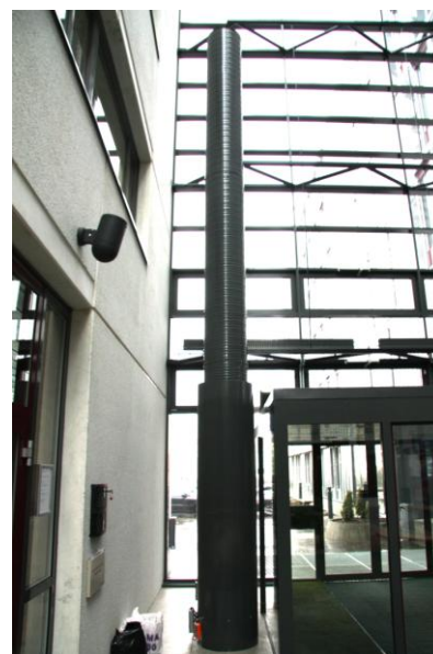
Figur 8, Fortrengningsventilasjon i glassgården
