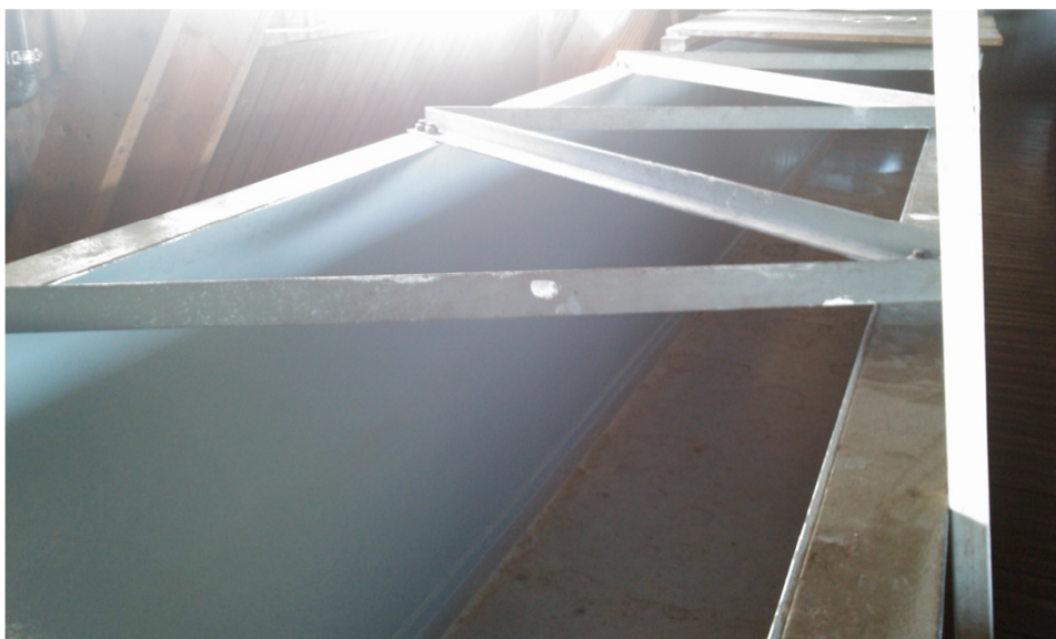
Figur 4-3, Vannrenne på loftet over vannkraftlabben
