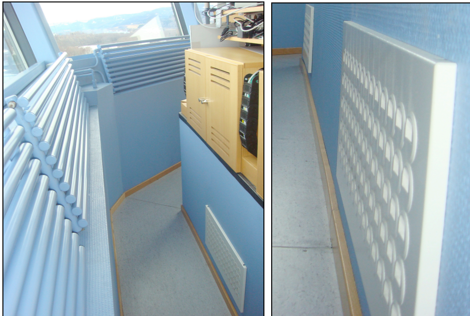
Figur 43 og Figur 44: Radiatorer plassert under vinduene(t.v), og tilluftsventilene plassert lavt i teknisk mellomgulv
